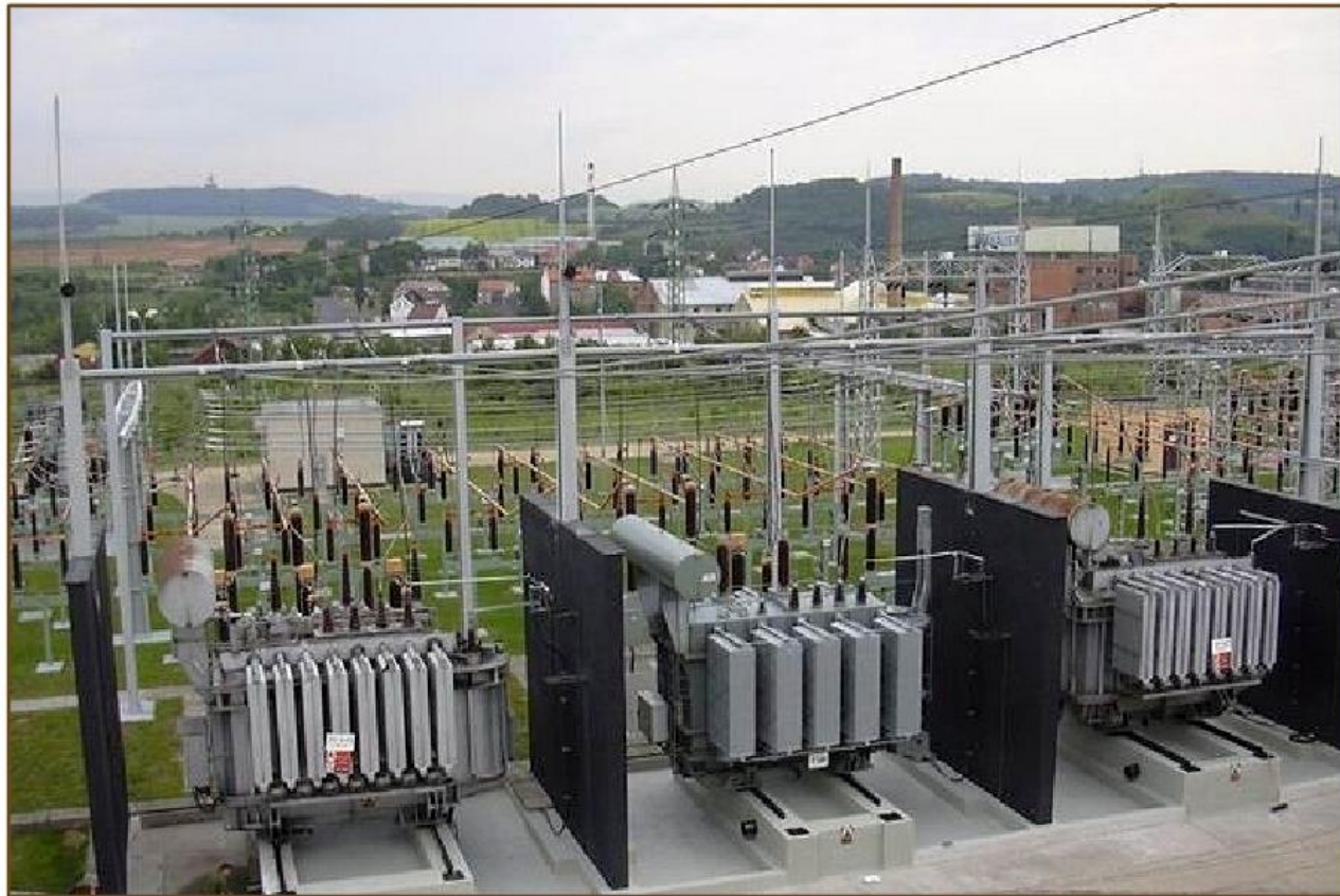
Městská transformátorová stanice s trojfázovými transformátory, ze které se do městských čtvrtí rozvádí vysoké napětí 22 kV
